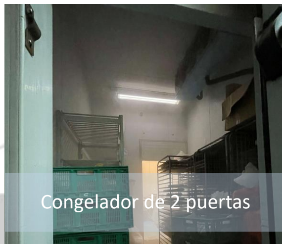
Cámara frigorífica de 2 puertas
